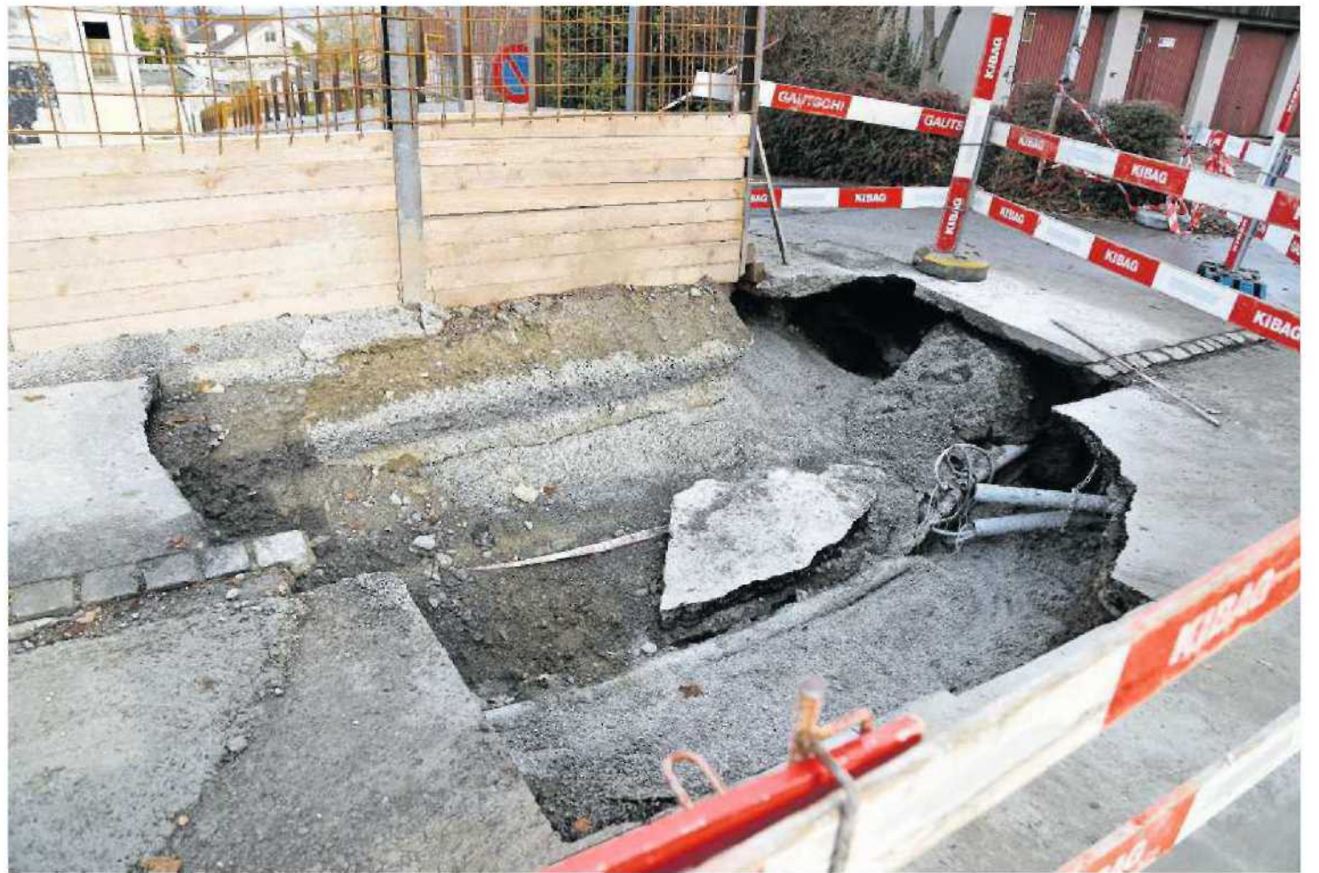
Sofern die Leitungen unversehrt geblieben sind, können Arbeiter das Loch an der Löwengartenstrasse bald wieder auffüllen. Bild: Janina Gehrig
